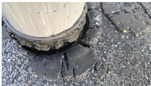
Før: Nærbillede af nedbrudt overgang ved airlift.
