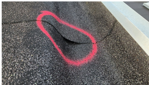
Før: Åben og dårlig samling i skotrenden.
