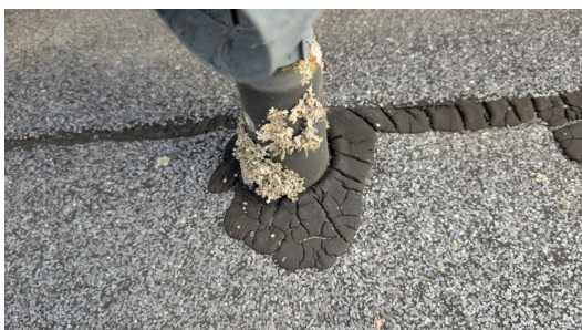
Før: Revnet og nedbrudt tætning omkring en solcellefod.
