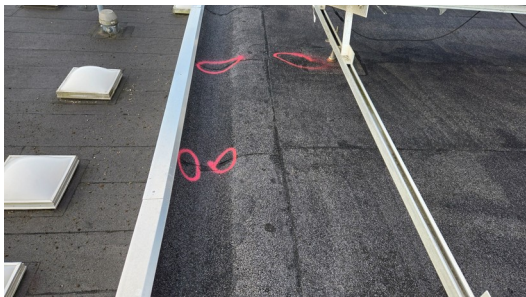
Før: Dårlige samlinger i skotrenden opmærket før udbedring.
