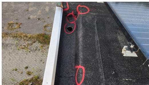
Registrering: Flere markerede svage punkter under solcelleanlægget.
