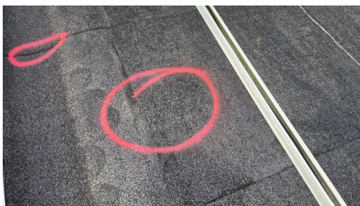
Før: Mindre dampbule markeret før udbedring.
