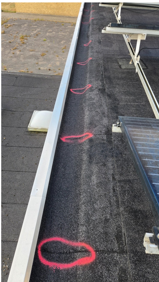
Registrering: Flere opmærkede skader langs tagkanten.
