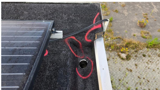
Registrering: Skader og åbninger omkring nedløb og tagkant.
