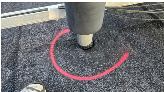
Før: Revner og svigt i tætningen ved større airlift.
