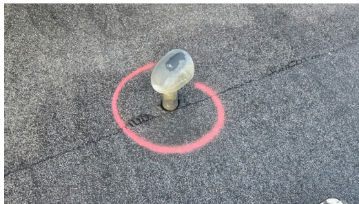
Før: Revnet tætning omkring mindre airlift.
