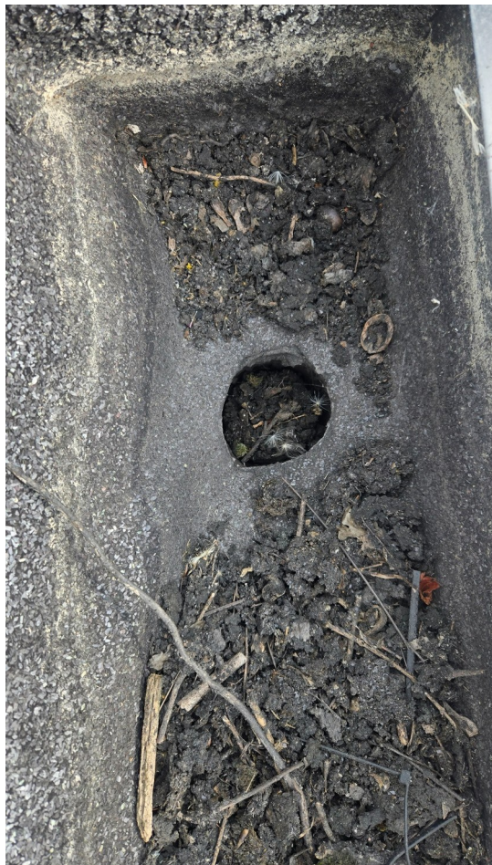
Før: Nedløb tilstoppet med jord og organisk materiale.
