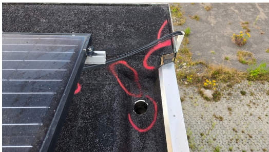
Før: Skader og svage samlinger omkring nedløb og tagkant.
