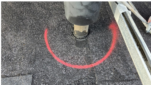
Før: Nedbrudt tætning omkring større airlift.
