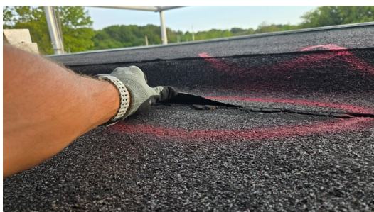
Før: Åben og løs tagsamling ved murkroner under solcelleanlægget.
