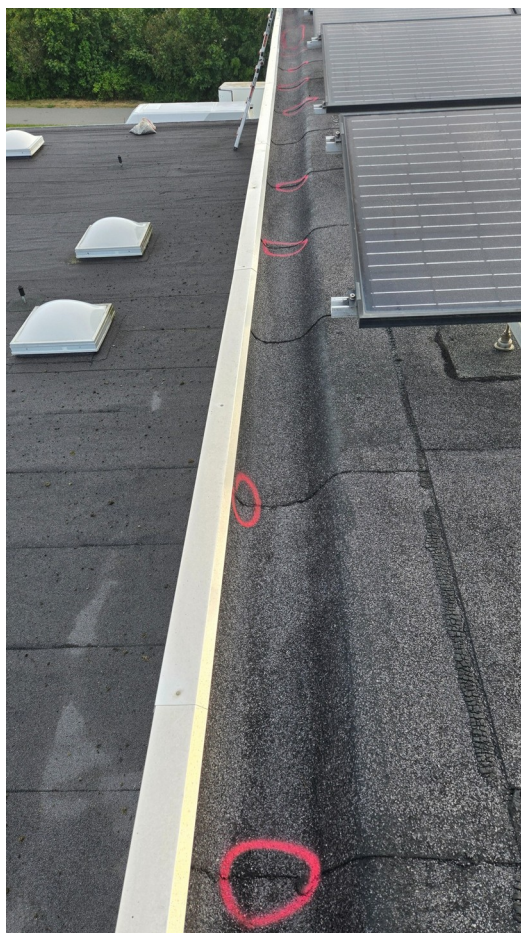
Registrering: Skader markeret over en længere strækning.
